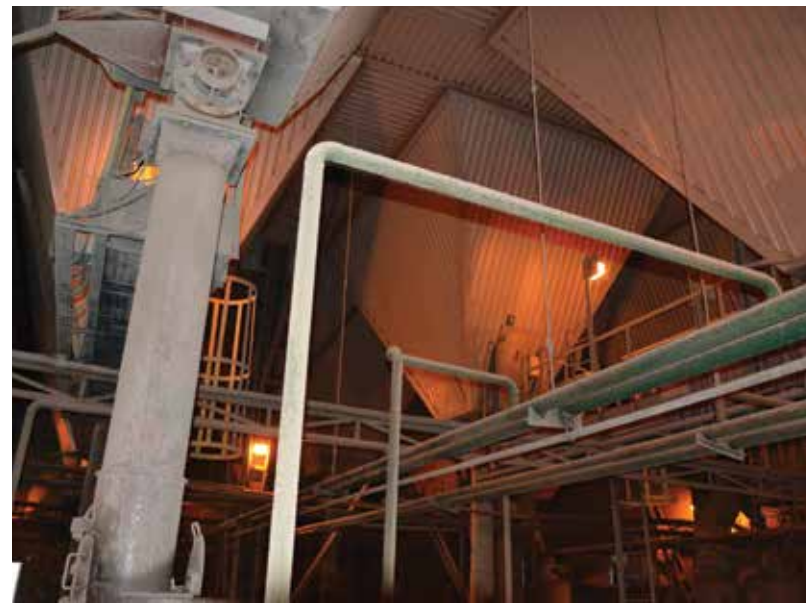
Бункеры золы электрофильтра
