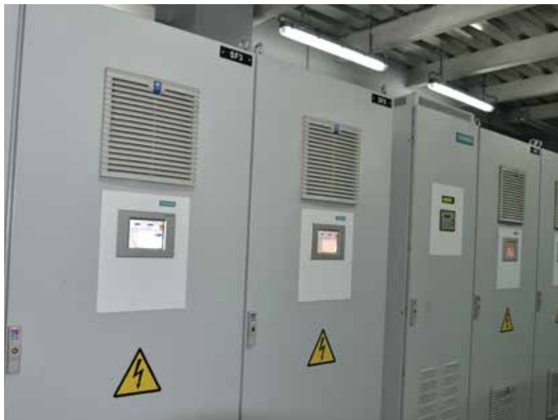
Электрическая подстанция электрофильтра
