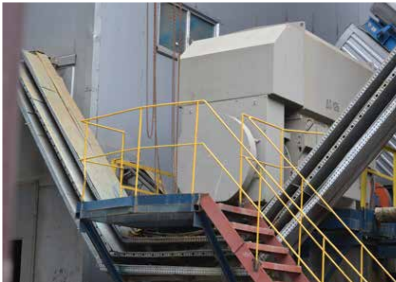
Дымосос 12Б электрофильтра
