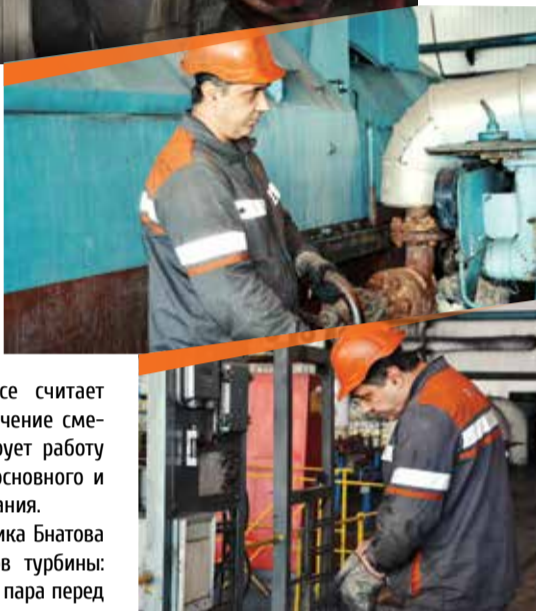
Контроль давления температуры водорода
